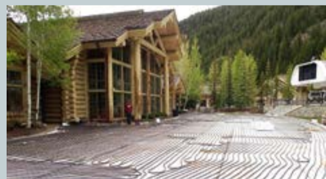
Figura 5. Il sistema di tubazioni installato al Sun Valley Ski Resort nell'Idaho
